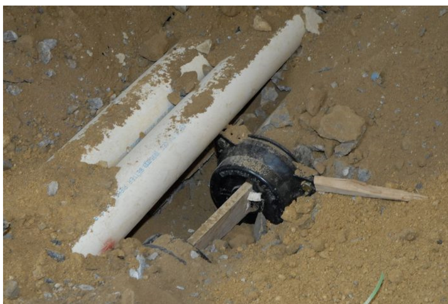
2006年油麻地寶靈街後巷地底煤氣喉進行防銹工程，灌注高壓氮氣期間，疑氣壓太大逼爆喉管。(資料圖片)
