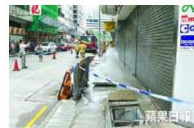
■電器店東主黎先生發現路面發熱報警，消防員在發熱路面射水降溫。劉栢麟攝
